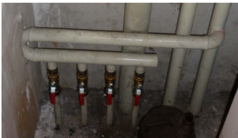
Photo 9 : Vannes d'arrêt des planchers chauffants dans les circulations
