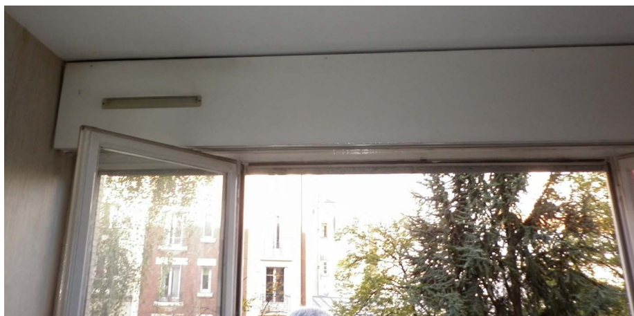
Photo 3 : Coffre de volet roulant intérieur avec entrée d'air
