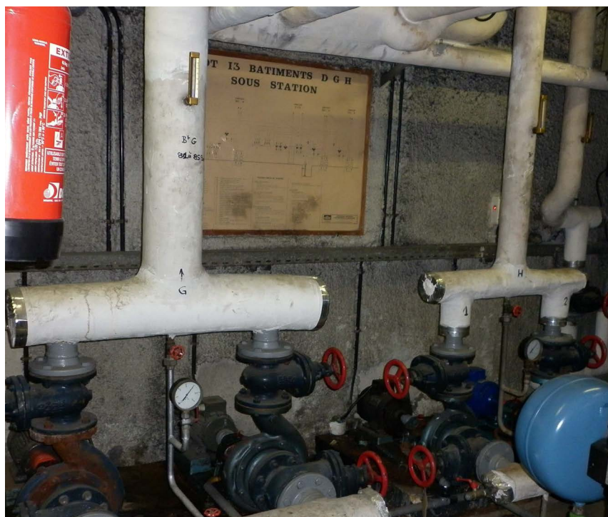
Photo 8 : Départ des réseaux de chauffage des bâtiments G et H
