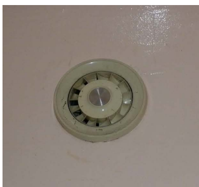
Photo 5 : Bouche d'extraction en WC et salle de bain
