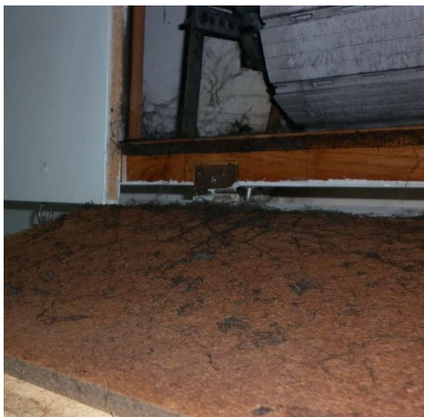
Photo 4 : Faible isolation à l'intérieur des coffres de volet roulant
