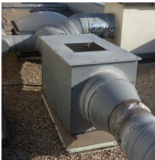
Photo 6 : Caisson d'extraction en toiture
